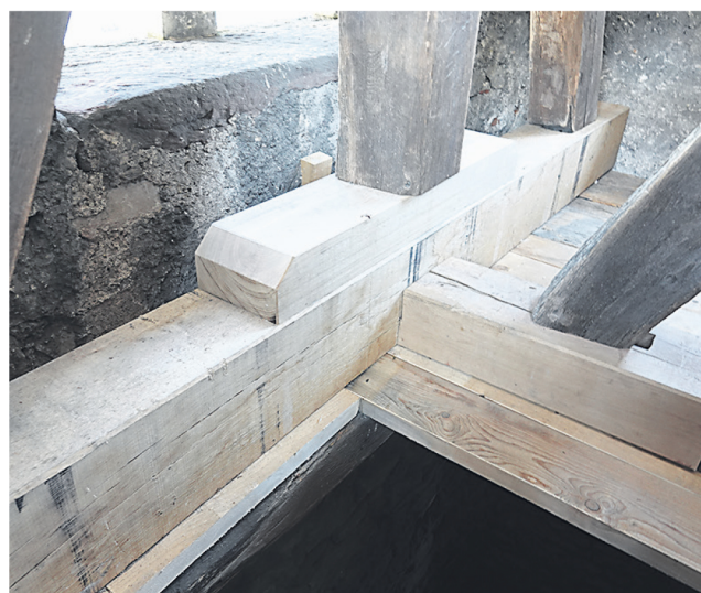
Der neue Balken im Glockenturm ist montiert. Vorher sah es so aus (rechts).
