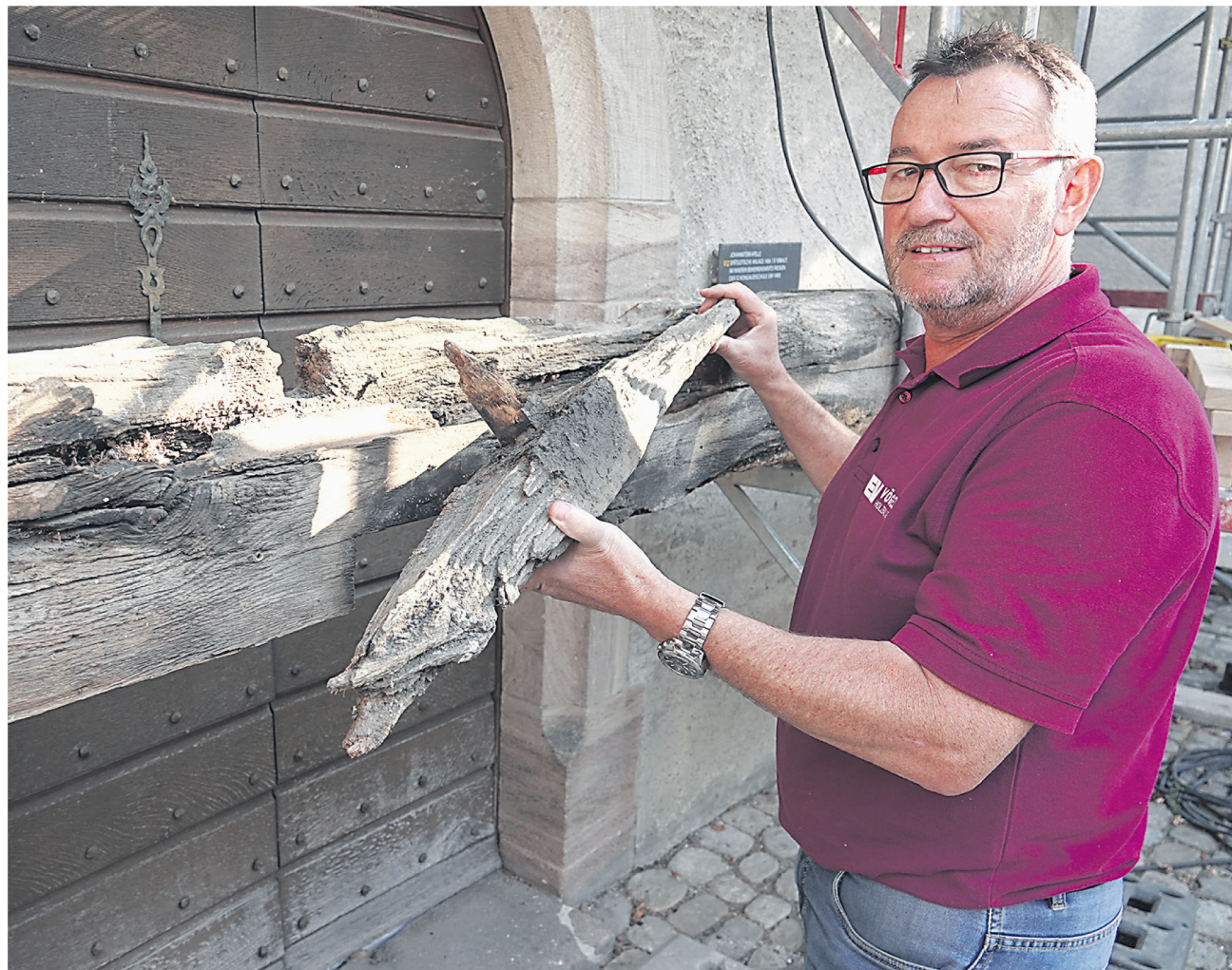
Alt und morsch: «Es kommt selten vor, dass ein Eichenbalken derart verfault ist», erklärt Toni Weiss von der Firma Vögeli Holzbau. Den alten Balken kann man beim Eingang zur Johanniterkapelle besichtigen. Foto: Valentin Zumsteg
